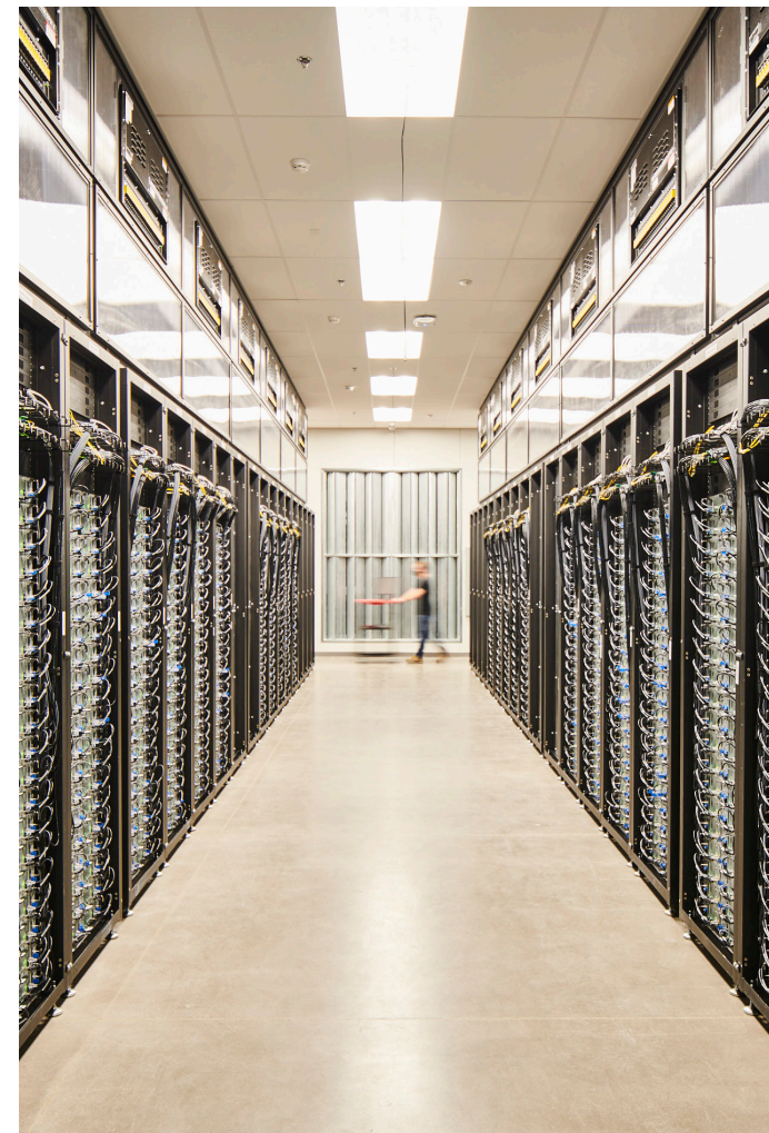
Apple 里诺数据中心于 2012 年投入运营, 充分利用当地温和的气候, 尽可能用外部空气冷却服务器。
